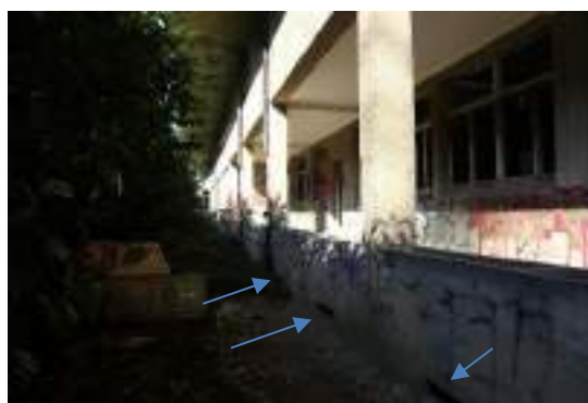
Façade Nord du bâtiment B (Lucarne 48 à 46 ; les ouvertures suivantes sont des sopiriaux jusqu'à l'extrémité du bâtiment) - Ecosphère
