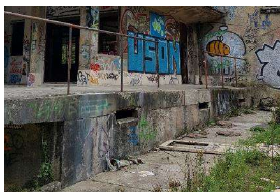
Façade Est du bâtiment B- Ecosphère
